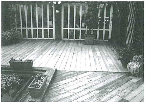
写真3 取替え2年経過
